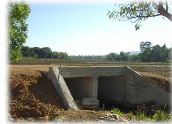
ท่อลอดเหลี่ยม
