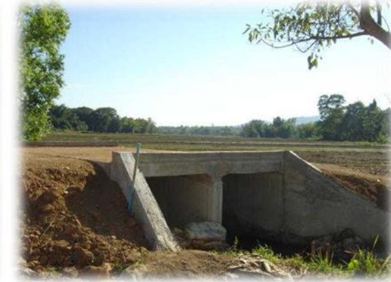
ท่อลอดเหลี่ยม
