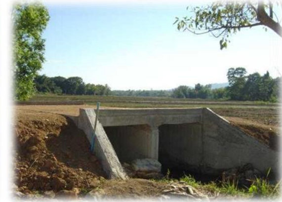
ท่อลอดเหลี่ยม
